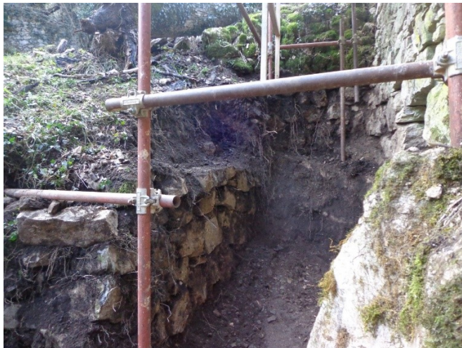
Slika 58: Istražni radovi iskopa – iskopano istočno pročelje, pronađen kameni zid na kojeg se oslanjala osovina mlinskog kola
