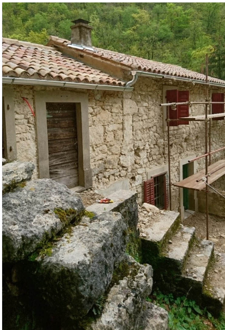
Slika 48: Objekt nakon otučenja žbuke pročelja
