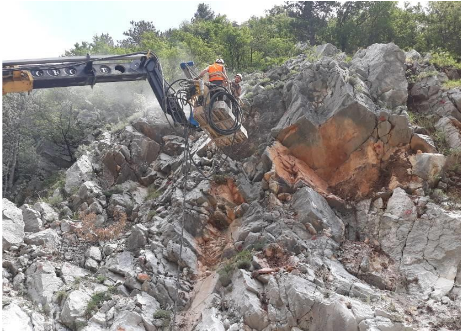
Slika 15. Stupanj potkopavanja prikazan na sedimentnom pokosu na državnoj cesti D501
