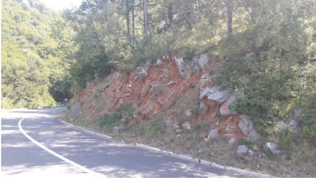
Slika 30. Blok u matriksu s veličinom bloka manjom od 30 cm - Križišće D501 (2)
