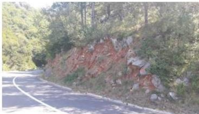
Slika 115. Predmetna kosina u sklopu inženjerskog bloka 1
