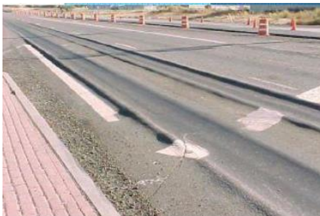
Slika 7: Oštećenje kolnika tipa kolotraženje [2]
