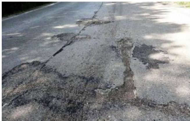
Slika 10: Oštećenje kolnika tipa krunjenje [9]
