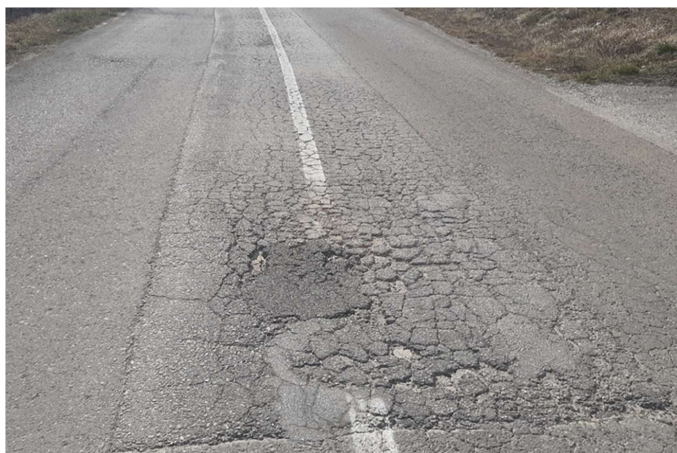
Slika 17: Mrežasta pukotina visokog stupnja oštećenja [foto autor]
