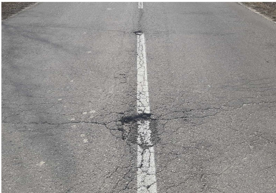
Slika 24: Udarne jame umjerenog stupnja oštećenja [foto autor]
