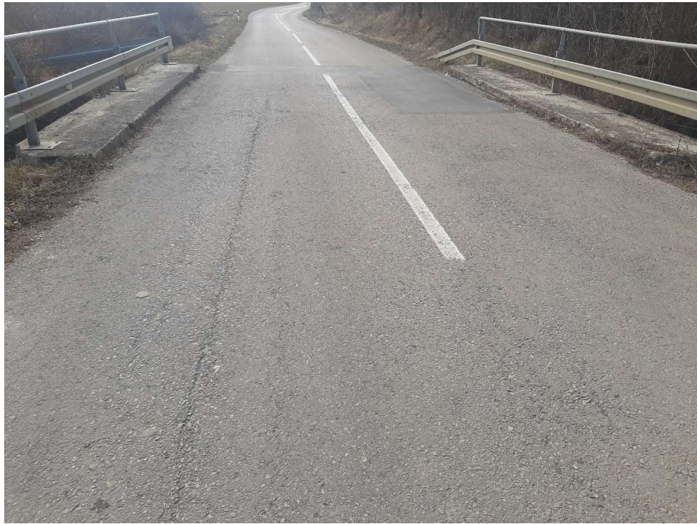
Slika 22: Uzdužna pukotina umjerenog stupnja oštećenja [foto autor]
