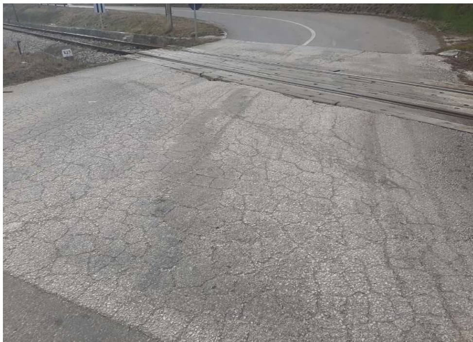
Slika 16: Mrežasta pukotina srednjeg stupnja oštećenja [foto autor]
