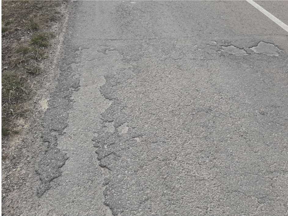
Slika 29: Odvajanje završnog sloja visokog stupnja oštećenja [foto autor]
