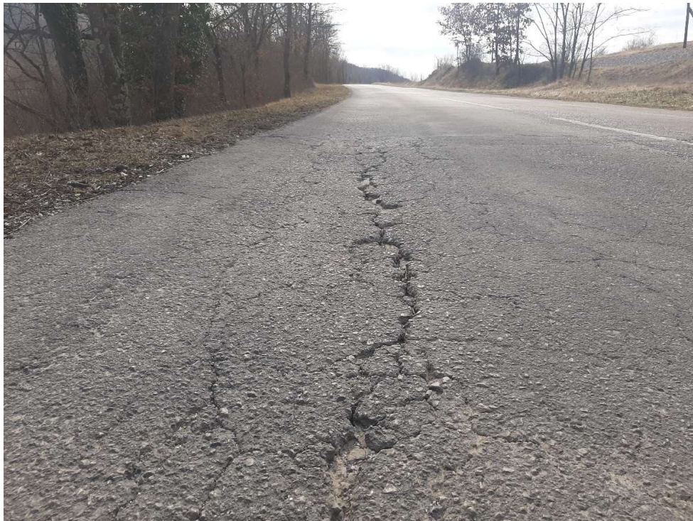
Slika 23: Uzdužna pukotina visokog stupnja oštećenja [foto autor]
