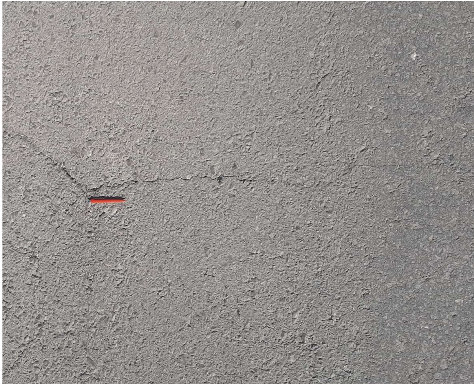
Slika 18: Poprečna pukotina niskog stupnja oštećenja [foto autor]
