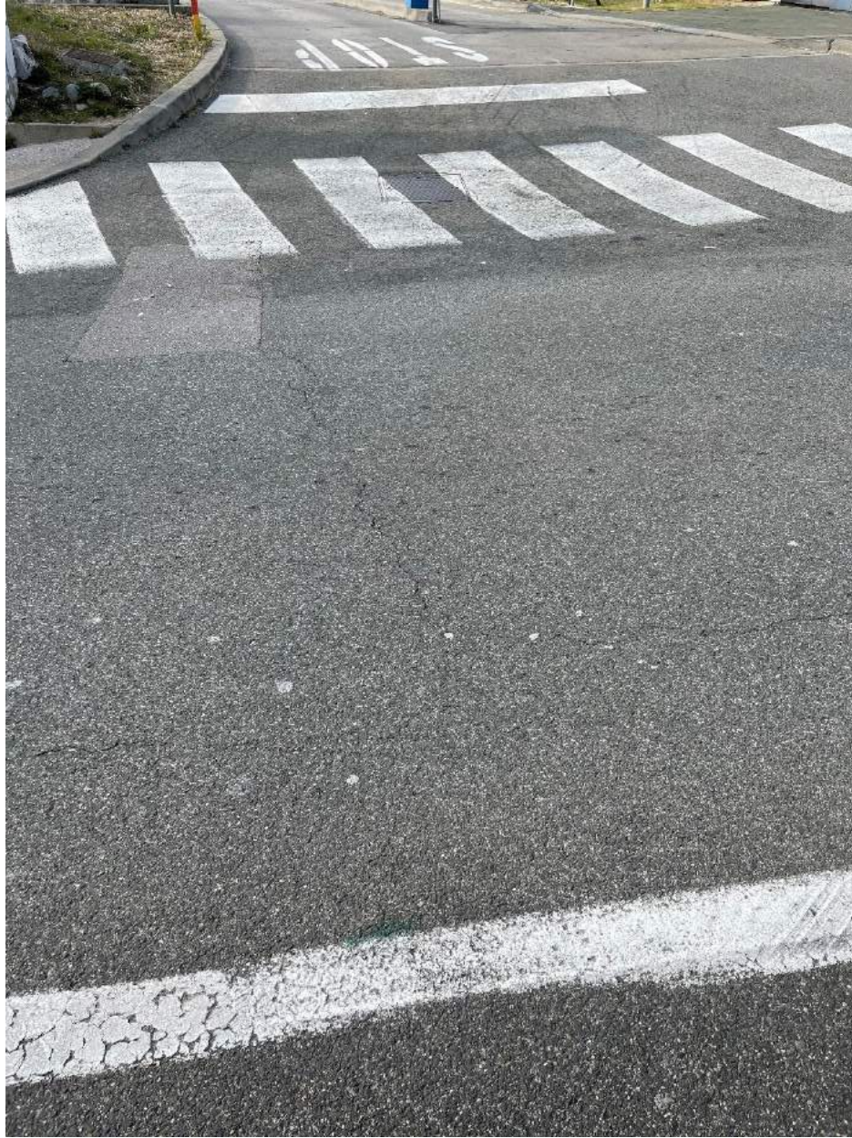
Slika 36: Popravak i poprečna pukotina (niski stupanj oštećenja)
