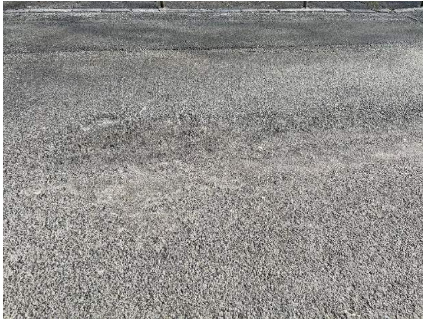
Slika 68: Krunjenje asfalta (visoki stupanj oštećenja)
