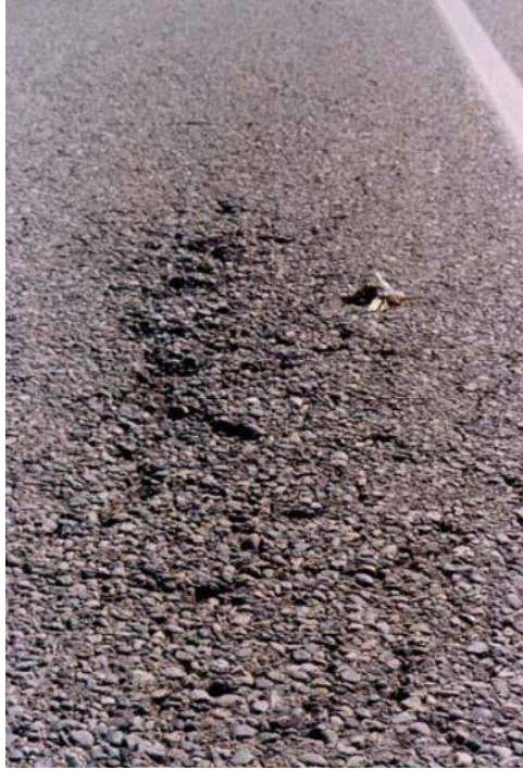
Slika 20: Visoki stupanj oštećenja (krunjenje) [12]
