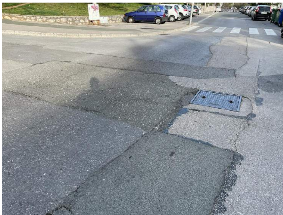
Slika 75: Popravci (visoki stupanj oštećenja)
