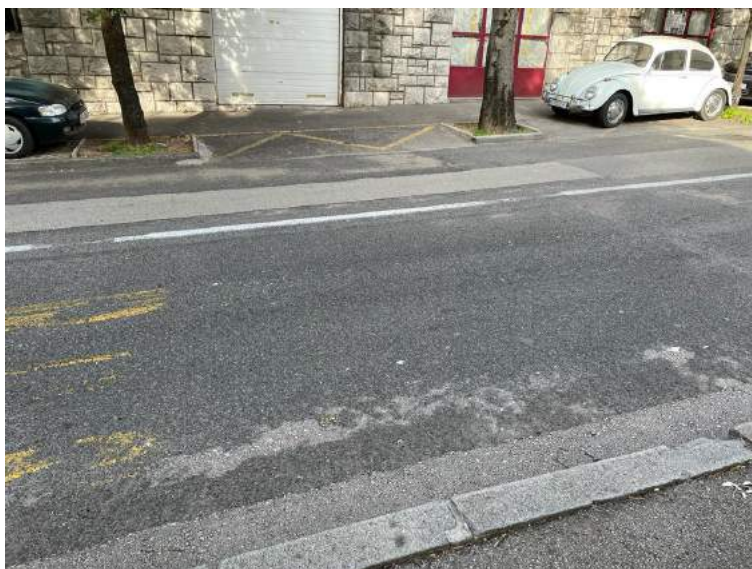
Slika 59: Krunjenje asfalta (visoki stupanj oštećenja)
