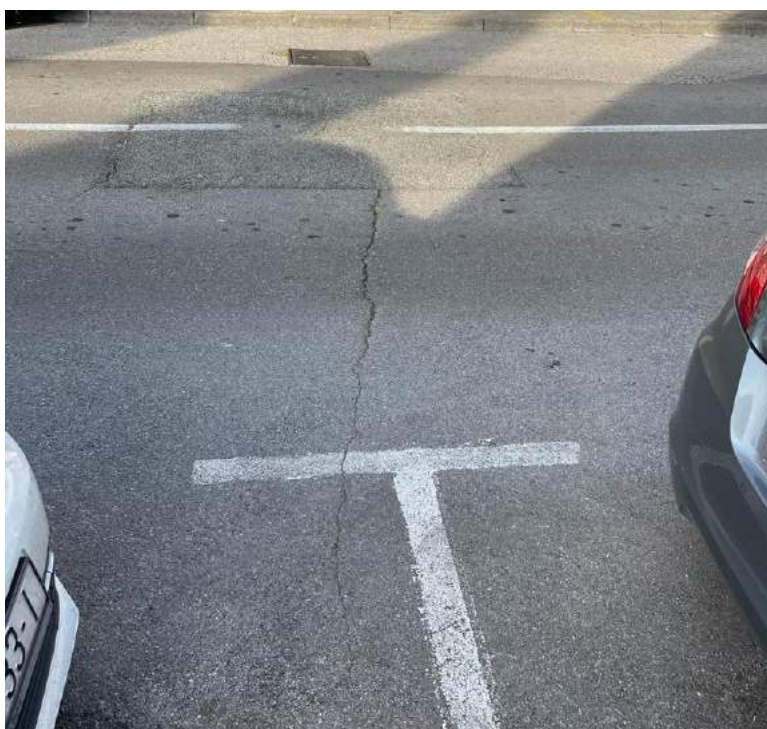
Slika 88: Poprečna pukotina (visoki stupanj oštećenja)
