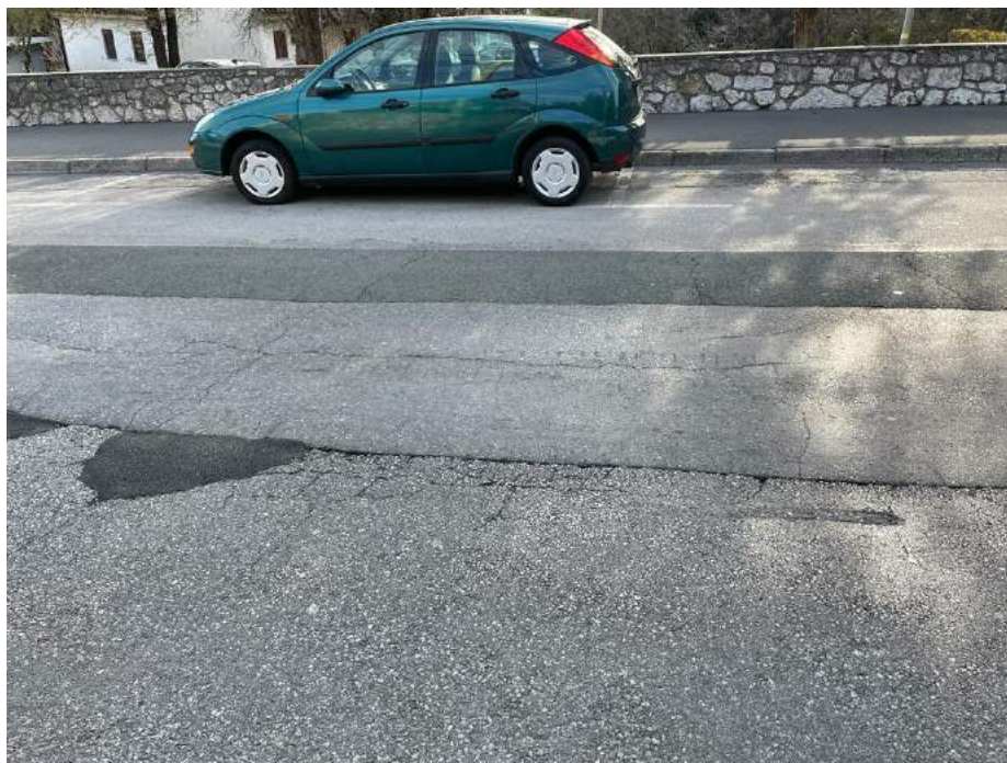
Slika 74: Uzdužne i poprečne pukotine (visoki stupanj oštećenja)
