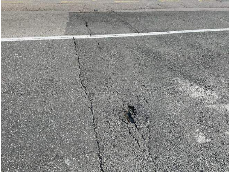
Slika 80: Poprečne pukotine i odlamanje habajućeg sloja asfalta (visoki stupanj oštećenja)
