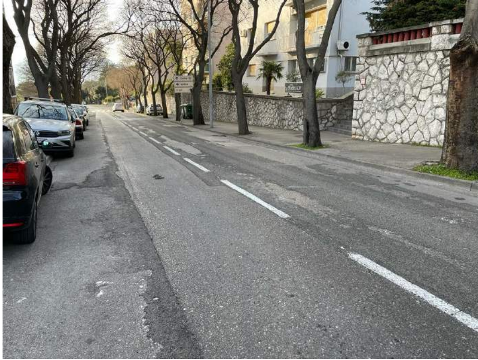
Slika 93: Krunjenje asfalta (visoki stupanj oštećenja)
