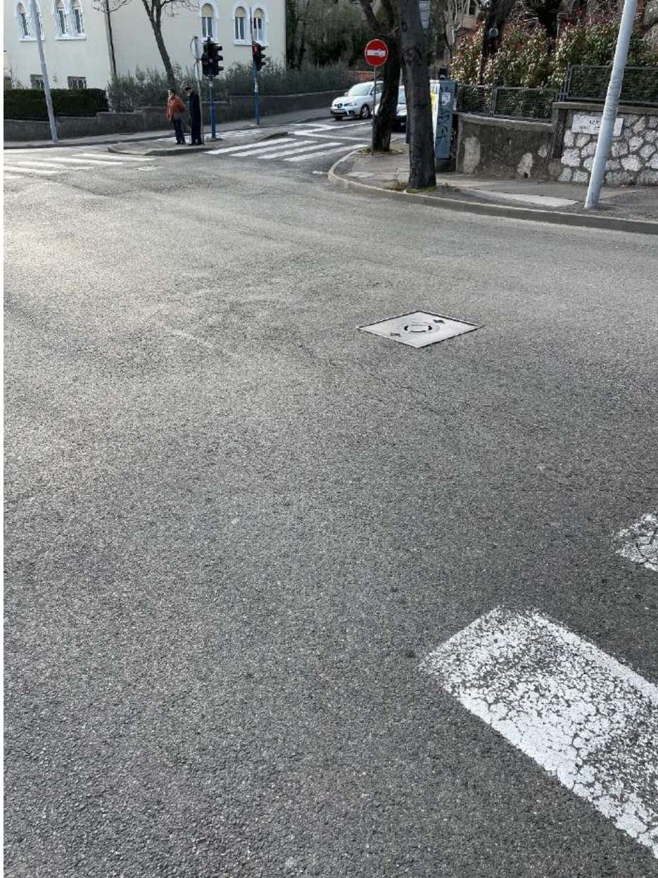
Slika 35: Mrežasta pukotina (umjeren stupanj oštećenja)
