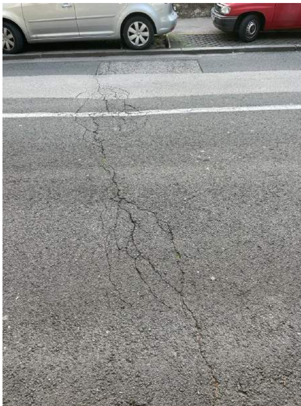
Slika 57: Poprečne pukotine (visoki stupanj oštećenja)
