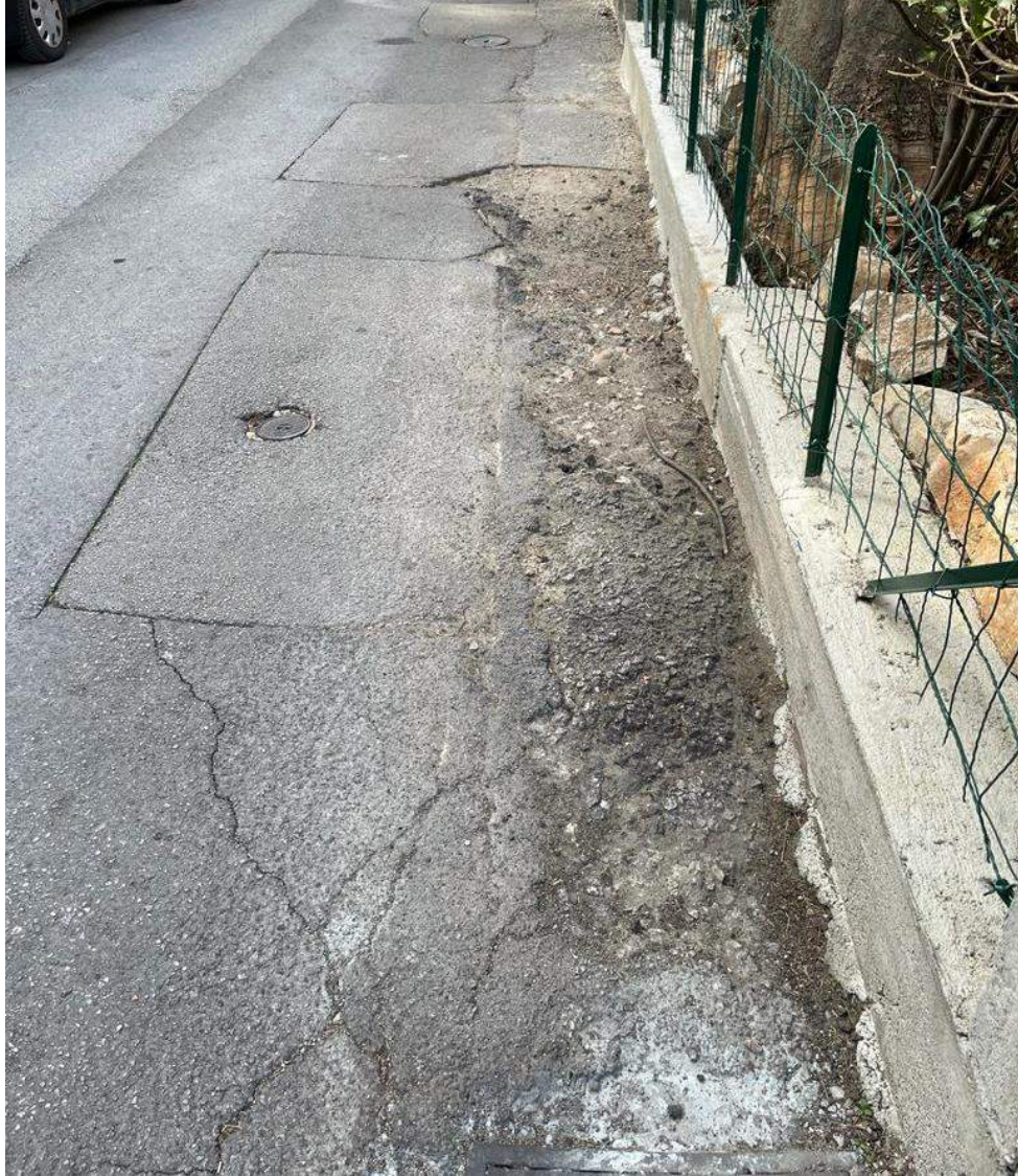
Slika 103: Odlamanje završnog sloja asfalta (visoki stupanj oštećenja)
