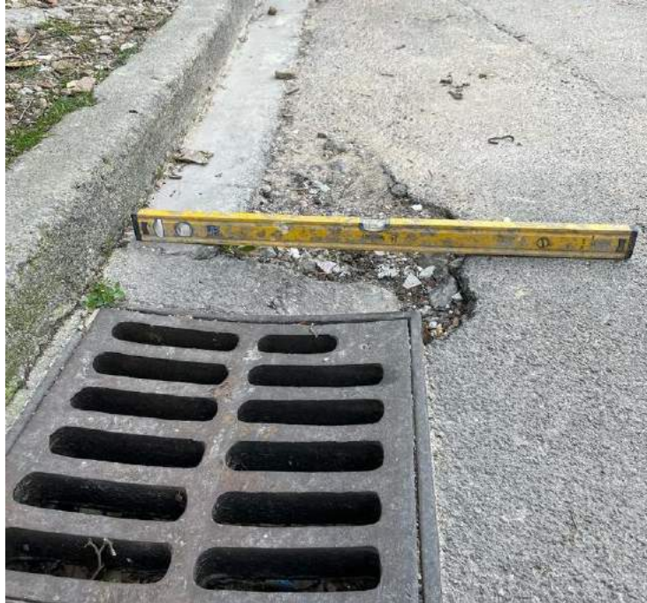
Slika 101: Odlamanje završnog sloja asfalta (visoki stupanj oštećenja)
