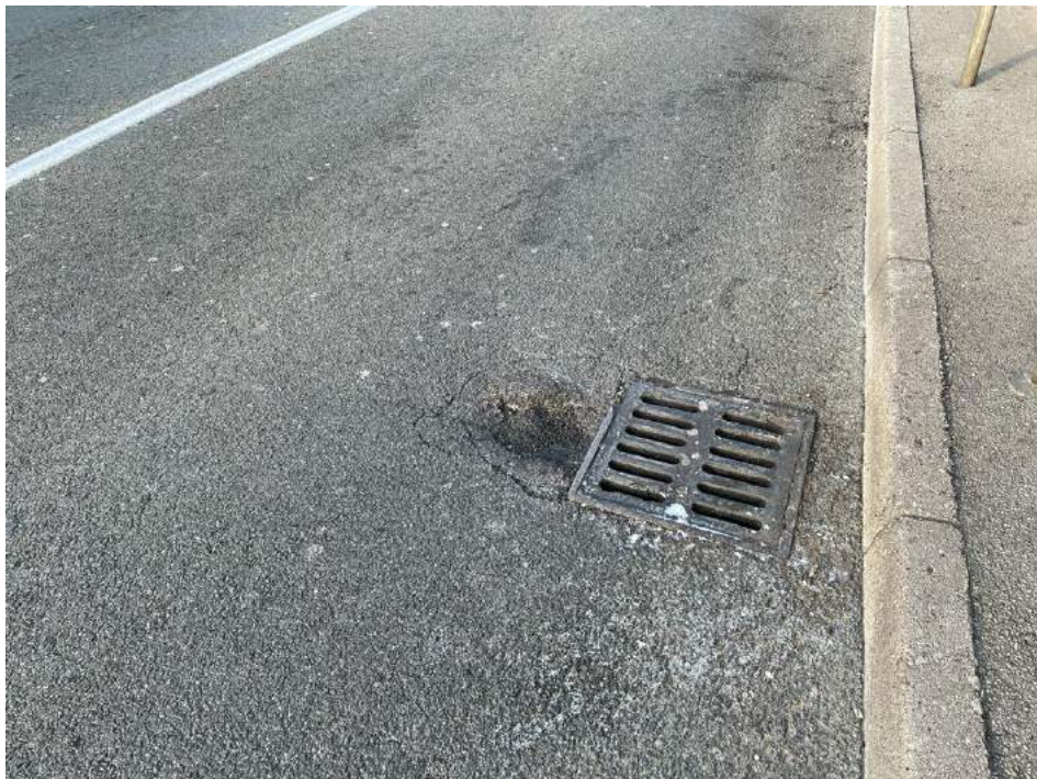
Slika 54: Odlamanje završnog sloja asfalta (visok stupanj oštećenja)
