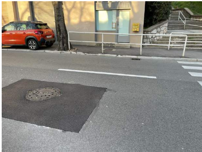
Slika 46: Popravak u ulici Janka Polić Kamova (stupanj oštećenja umjeren)
