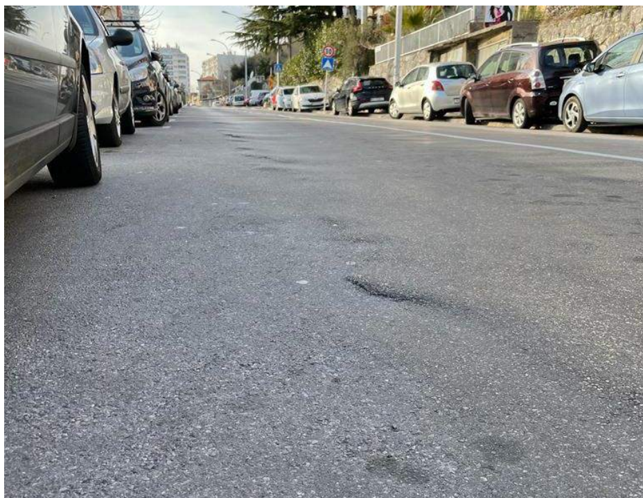
Slika 87 : Kolotrazi (visoki stupanj oštećenja)
