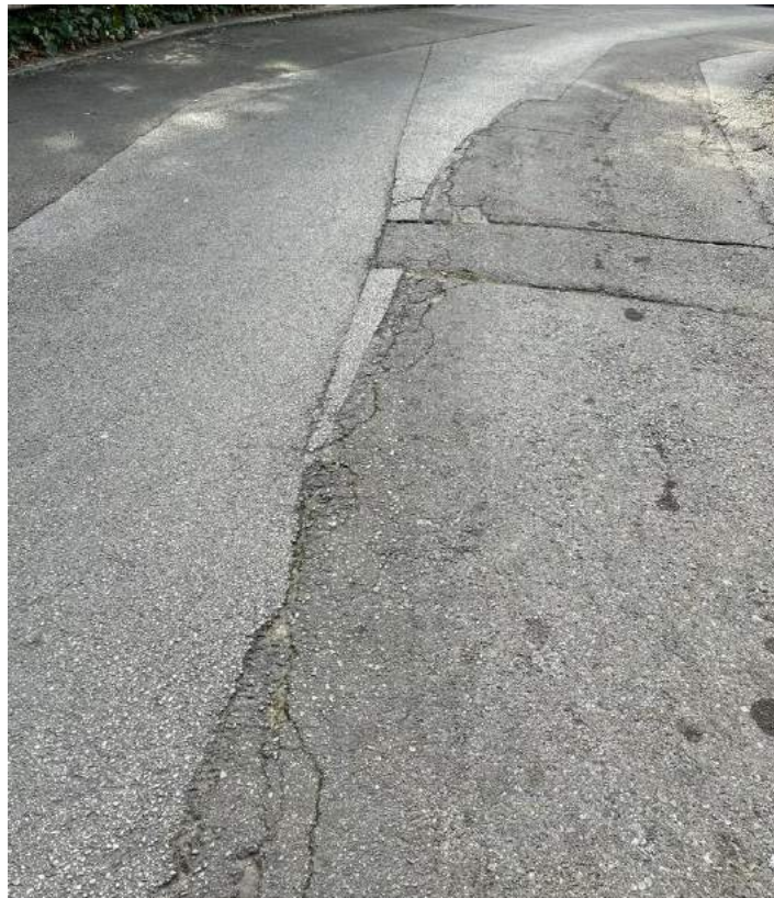
Slika 102: Popravci i uzdužne pukotine (visoki stupanj oštećenja)
