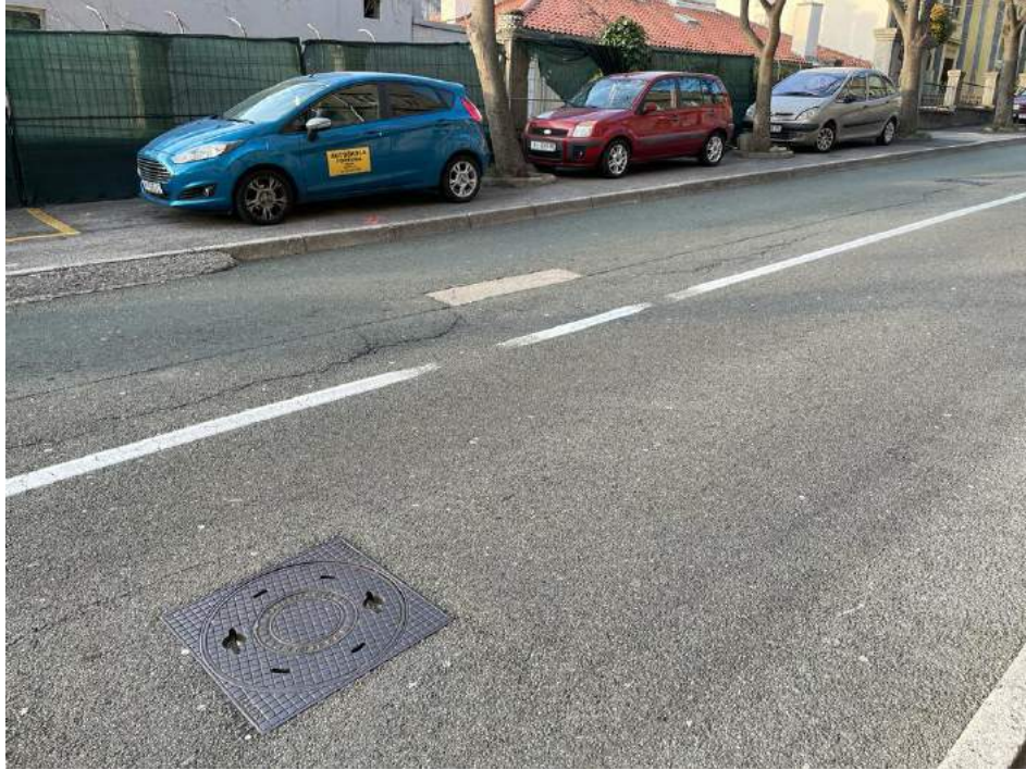
Slika 53: Uzdužne pukotine (umjeren stupanj oštećenja)
