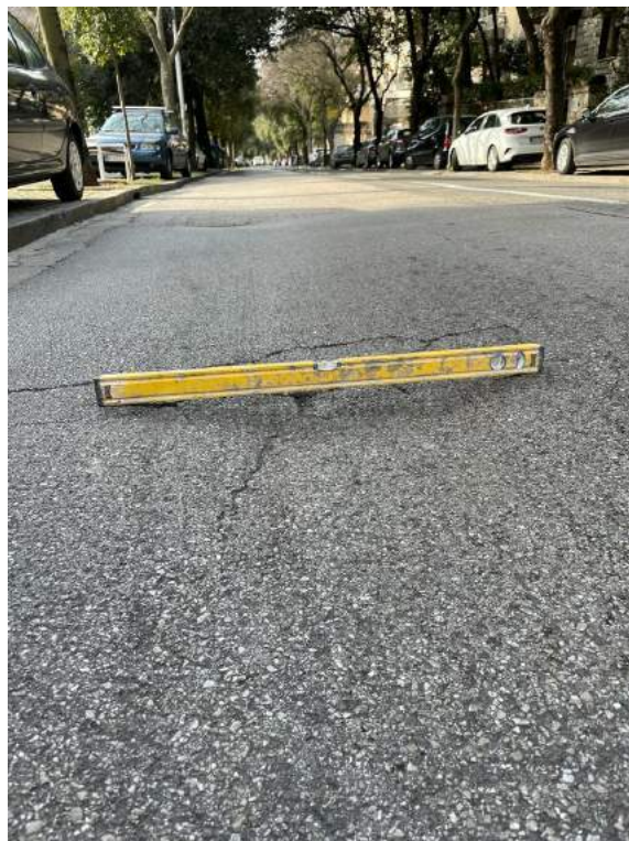
Slika 62: Ulegnuće asfalta (visoki stupanj oštećenja)
