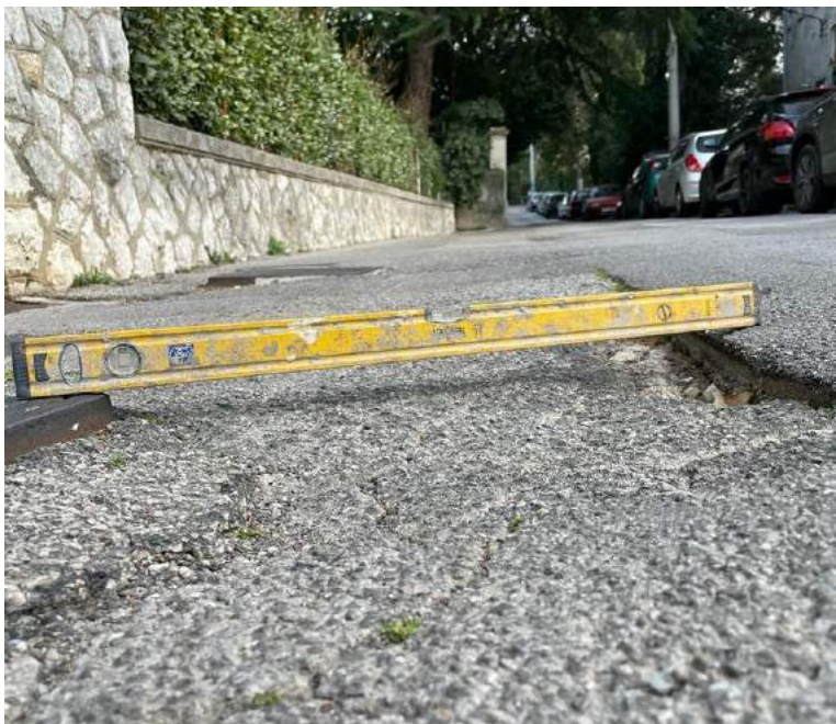
Slika 106: Ulegnuće asfalta (visoki stupanj oštećenja)
