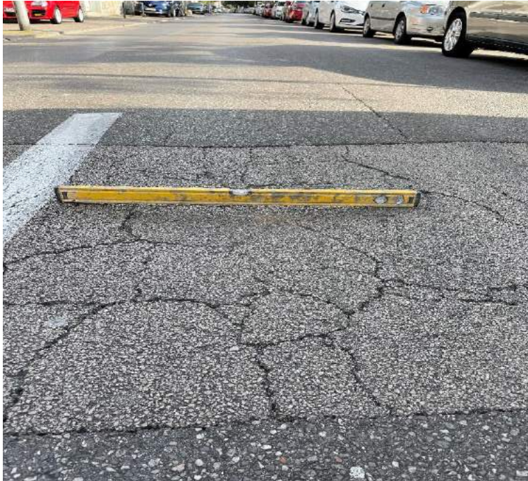
Slika 67: Mrežasta pukotina i ulegnuće (visoki stupanj oštećenja)
