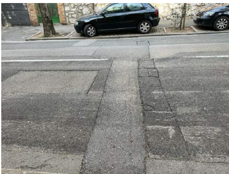
Slika 61: Popravci (visoki stupanj oštećenja)
