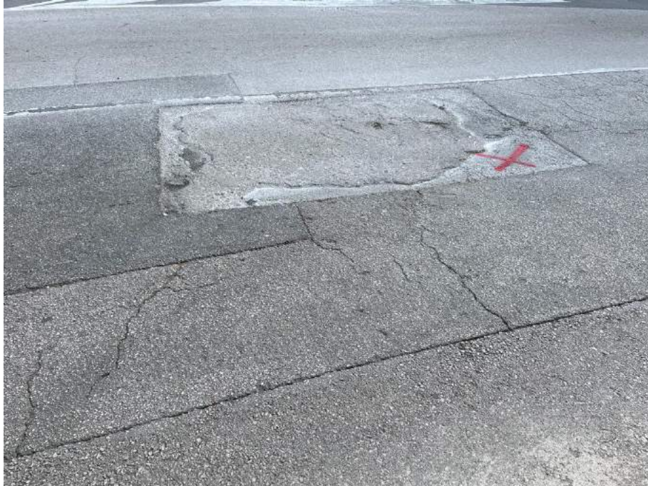
Slika 81: Popravci (visoki stupanj oštećenja)
