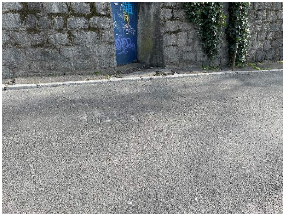
Slika 69: Poprečne pukotine (umjeren stupanj oštećenja)
