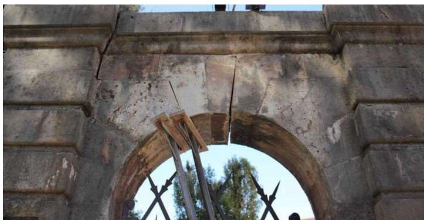
Slika 13. Pojava zgloba na lučnoj konstrukciji [7]
