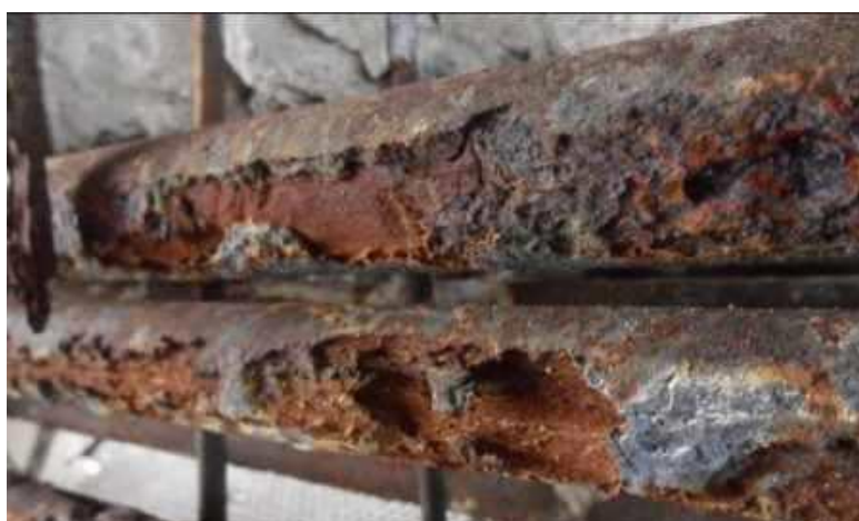
Slika 14. Korozija armature izazvana djelovanjem slane vode [13]
