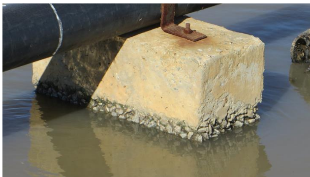
Slika 36. Oštećenje betona uzrokovano napadom sulfata [16]
