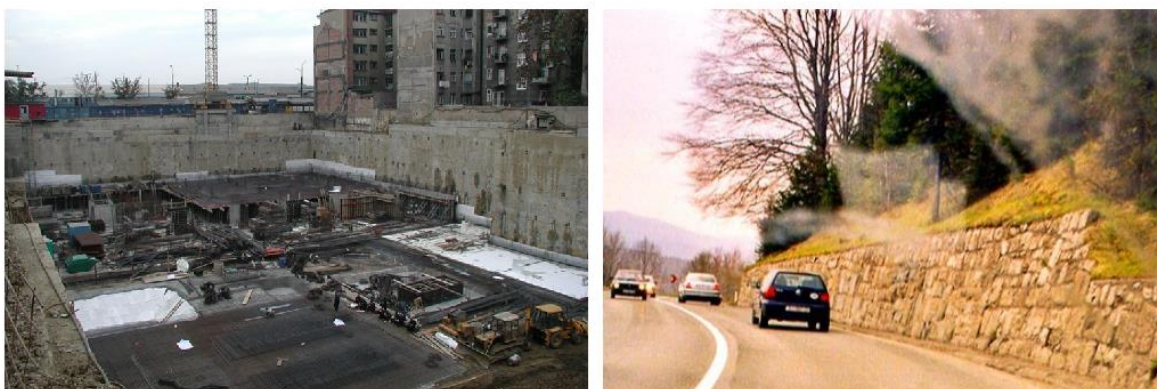
Slika 10. Primjer ugrađene i zasipane potporne konstrukcije – građevna jama „Branimir Centar“ te potporni zid uz prometnicu [13]
