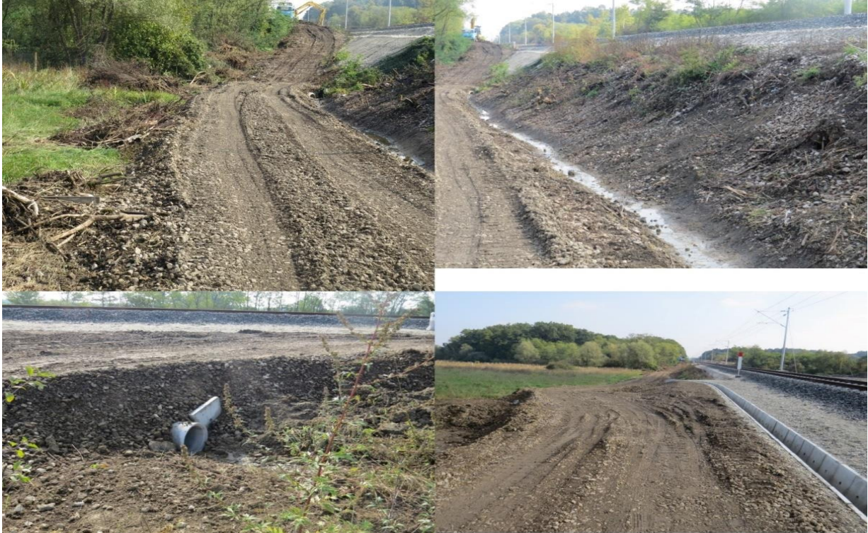
Slika 25. Odvodnja sa spojem na betonski propust, Pružne građevine
