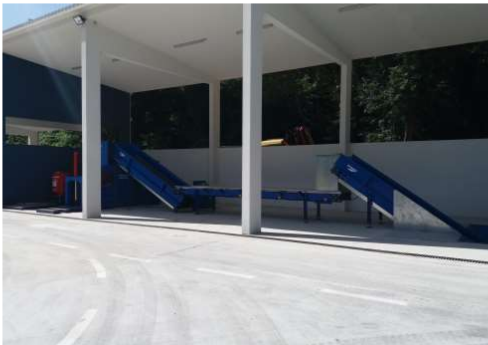
Slika 29. Sortirnica s transportnim trakama i balirkom ( Izvor: Grad Omiš, Upravni odjel za komunalnu i stambenu djelatnost, prostorno uređenje i zaštitu okoliša, pristup rujun 2022.)
