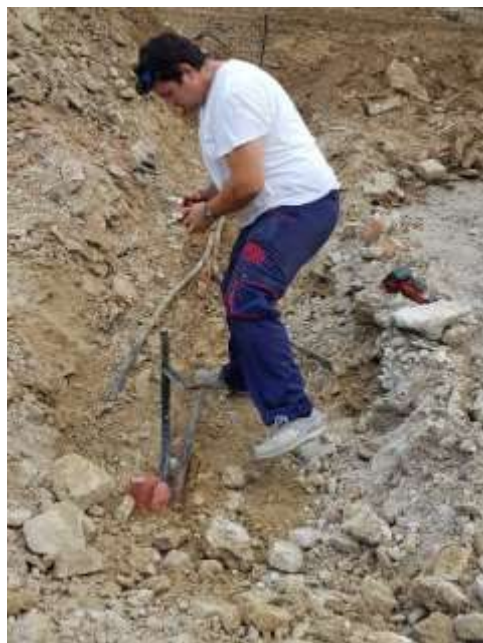
Slika 15. Spajanje na postojeću instalaciju i trasiranje voda ( Izvor: Grad Omiš, Upravni odjel za komunalnu i stambenu djelatnost, prostorno uređenje i zaštitu okoliša, pristup rujun 2022.)
