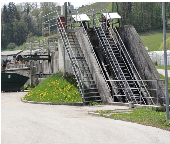
Slika 8: Crpna stanica s rešetkama
