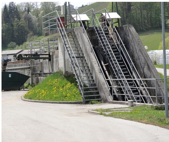
Slika 8: Crpna stanica s rešetkama
