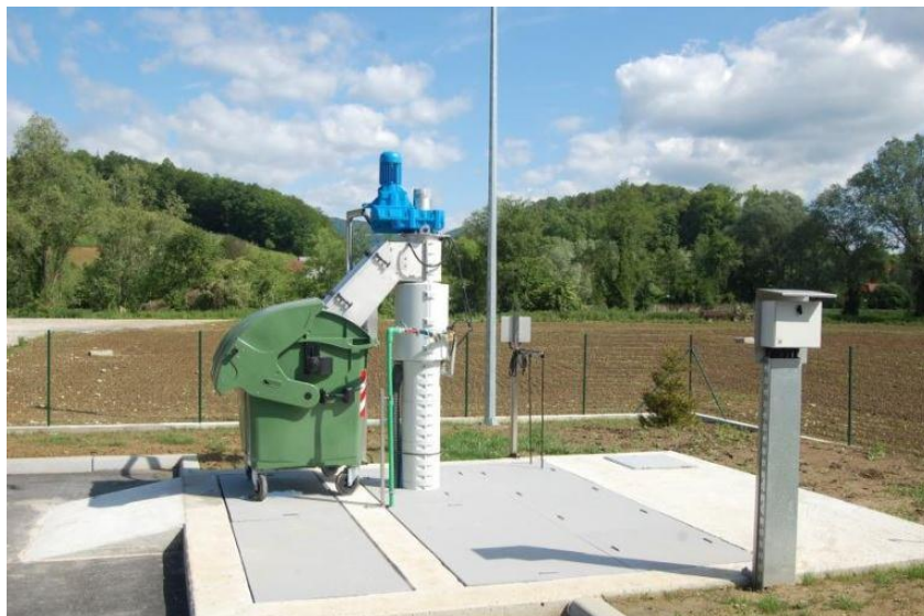
Slika 5: Ulazna crpna stanica
