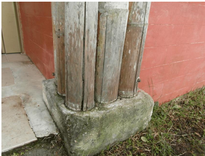
Slika 6: Oštećenje bambusa od gljivica i izloženosti atmosferilijama nakon otprilike 10 godina [16]
