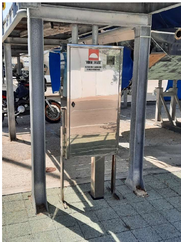
Slika 86: Prikazuje ormarić za opskrbu „vodene zavjese“ (foto autor)
