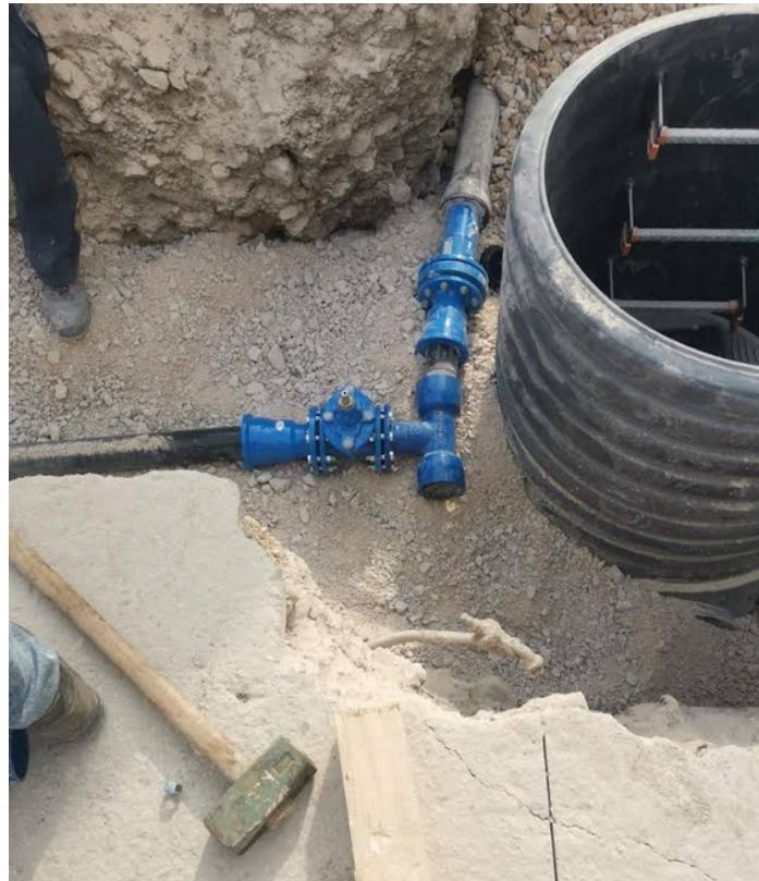
Slika 17. Čvor vodovoda na dionici Privlaka ( Marko Dujić)
