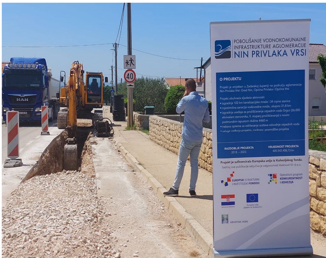
Slika 26. Prikaz stanja na gradilištu projekta poboljšanja vodnokomunalne infrastrukture aglomeracije Nin-Privlaka-Vrši (Marko Dujić)
