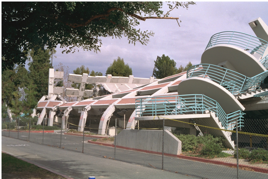
Slika 2.5: Oštećena garaža, potres Northridge, USA 1994. god. [5]
