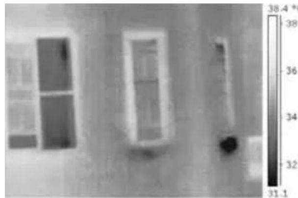
Slika 28 Prodor vlage ispod prozora zidane konstrukcije predstavljen tamnim trakama[15]
