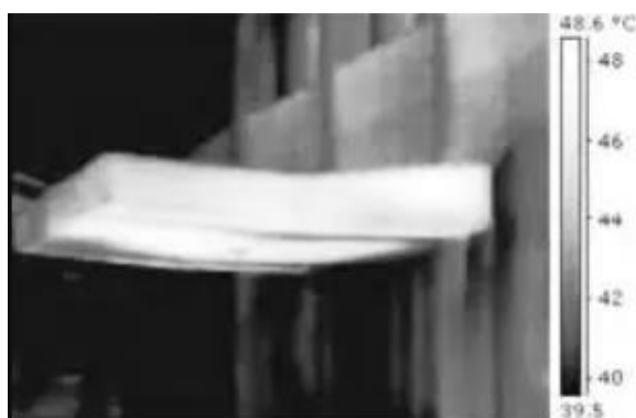
Slika 27 Termografija prodiranja vlage u nadstrešnicu.[15]
