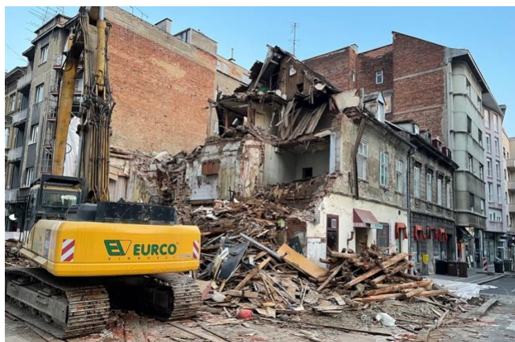
Slika 1: zgrada uništena djelovanjem potresa [3]
