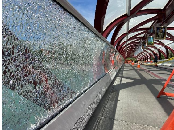
Slika 4: Vandalizam; "Peace bridge", Calgary, Canada [5]
