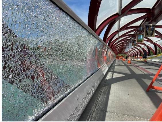
Slika 4: Vandalizam; "Peace bridge", Calgary, Canada [5]
