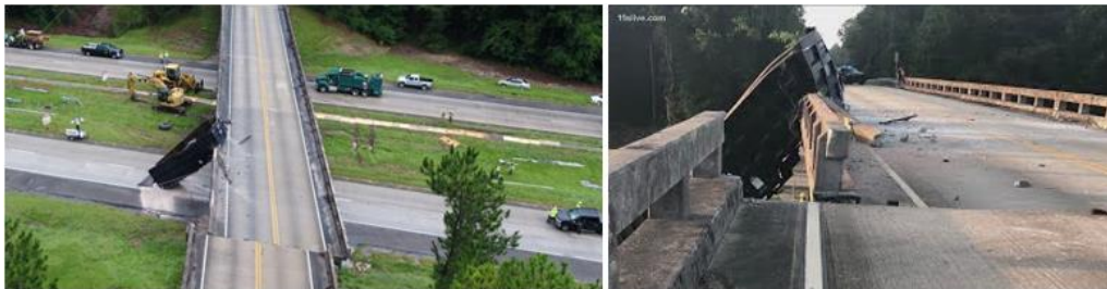
Slika 2: Pomak mosta nakon udara kamiona [3]
