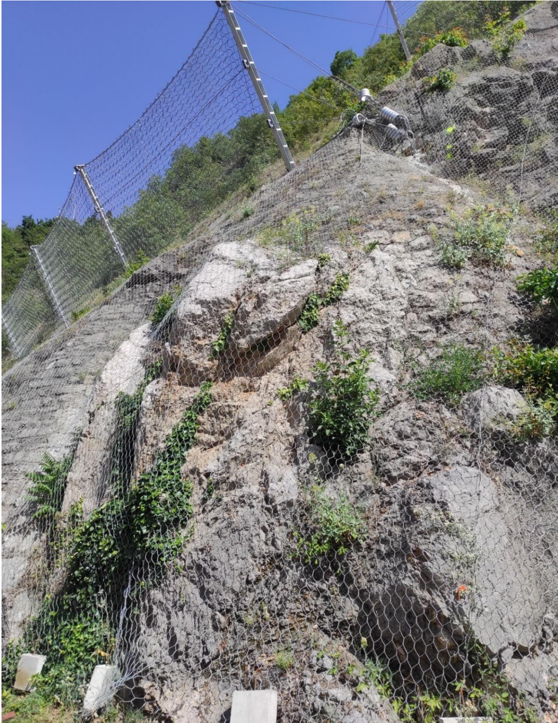
Slika 18. Zaštita pokosa heksagonalnom mrežom i barijerom za zaštitu od odrona
