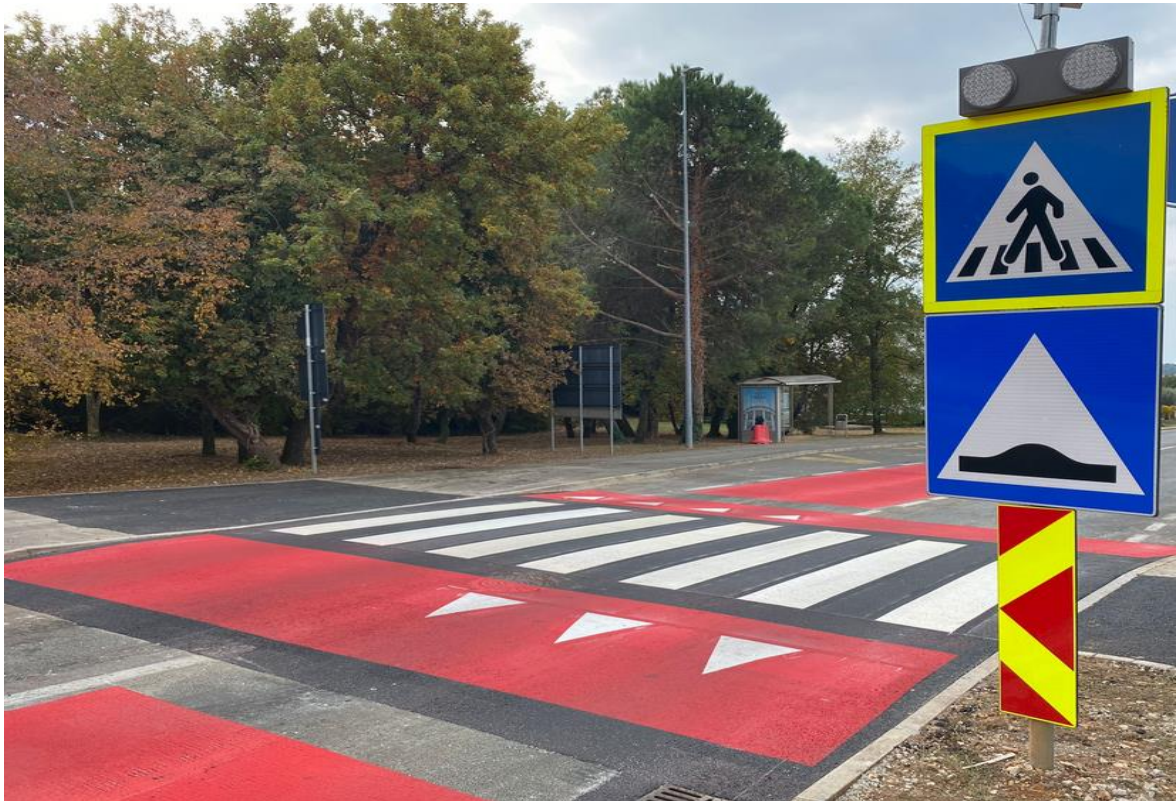
Slika 41. Uzdignuta ploha kolnika i obilježeni pješački prijelaz
