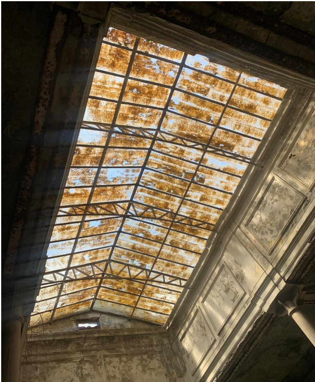
Slika 6: Stanje staklenog krova turske kupelji
