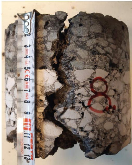
Slika 3: Uzorak jezgre asfaltnog zastora kod poprečne pukotine
