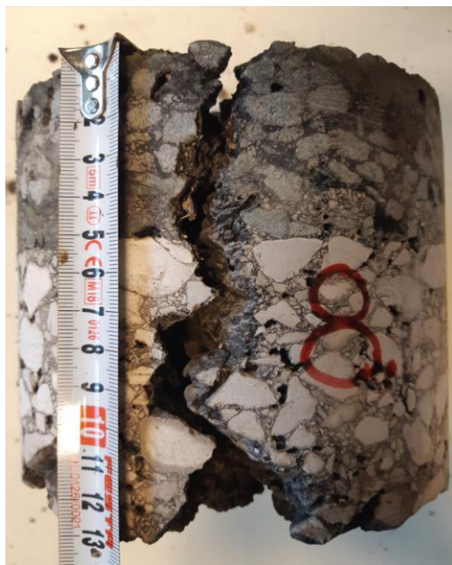
Slika 3: Uzorak jezgre asfaltnog zastora kod poprečne pukotine
