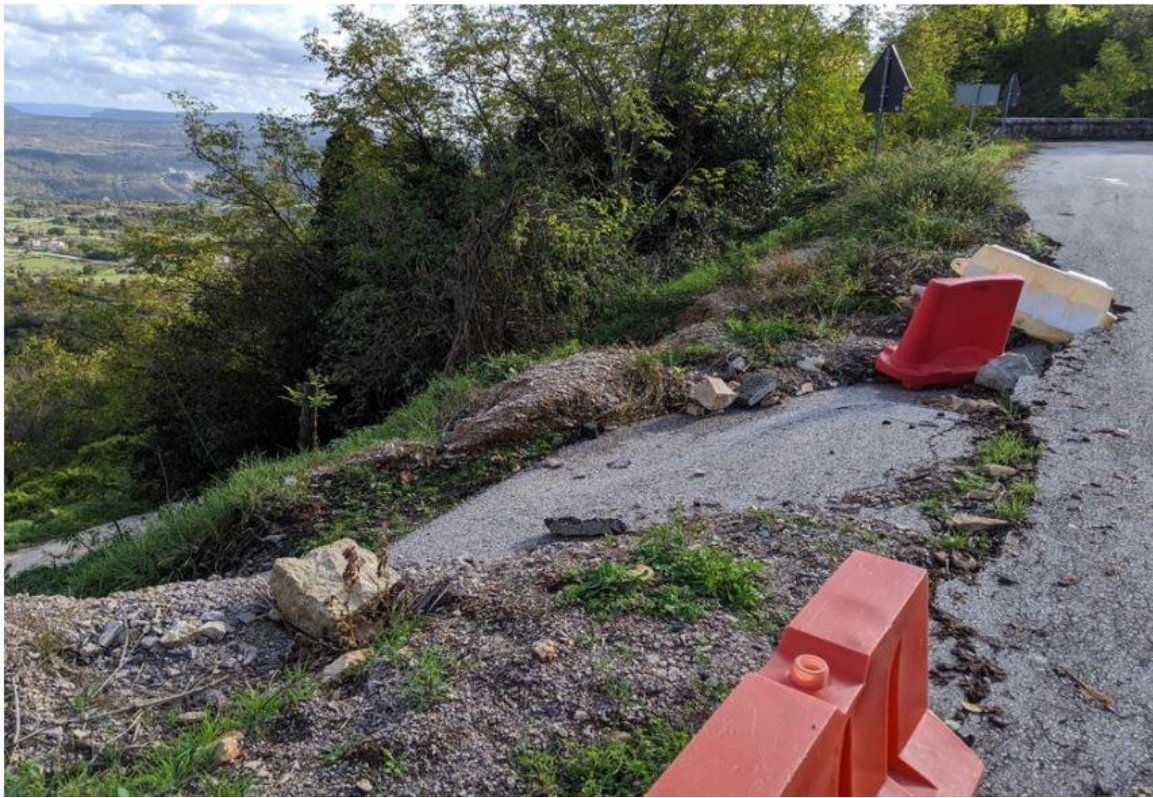
Slika 18 Oštećenje prometnice, klizište Pićan (preuzeto iz Gorupić, 2020)
