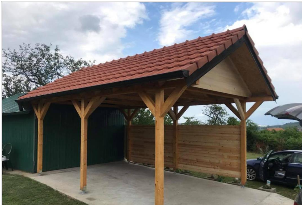
Slika 6. Primjer dvostrešne nadstrešnice [15]
