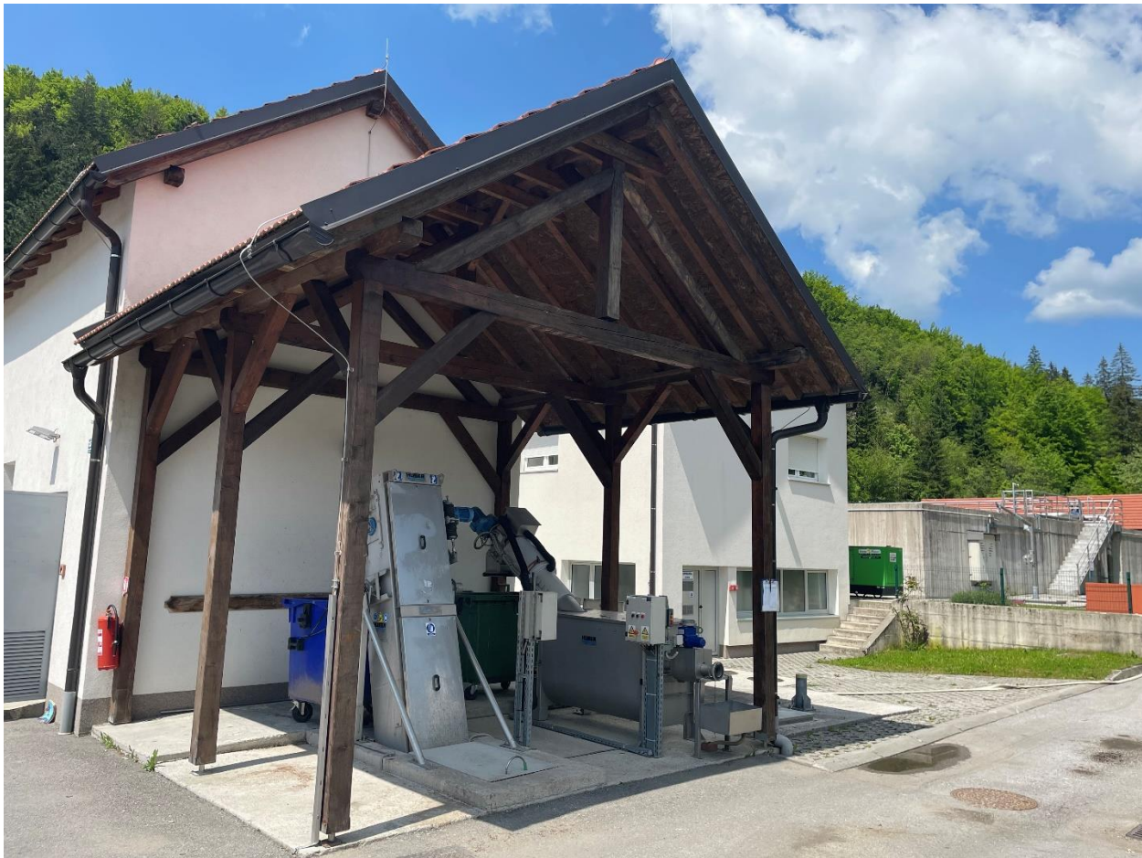
Slika 11. Automatska gruba rešetka i stanica za prihvata sadržaja septičkih i crnih jama (vlastita fotografija)
