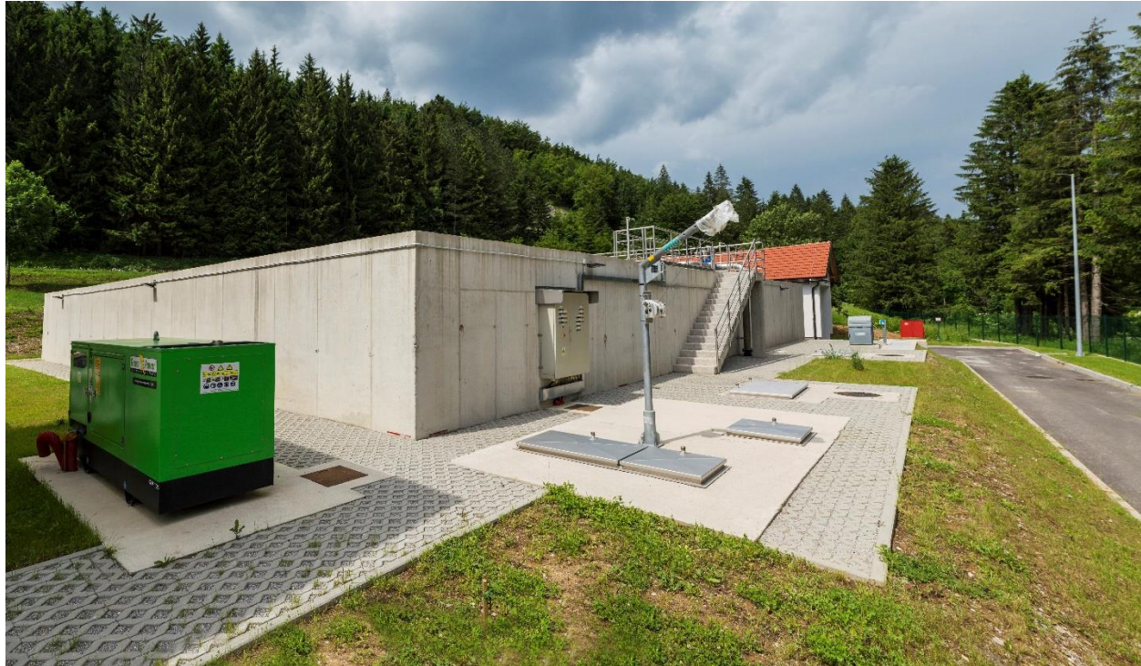
Slika 16. Crpna stanica ispred SBR reaktora (vlastita fotografija)
