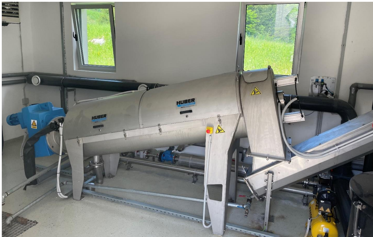
Slika 26. Spiralna presa u objektu dehidracije mulja (vlastita fotografija)
