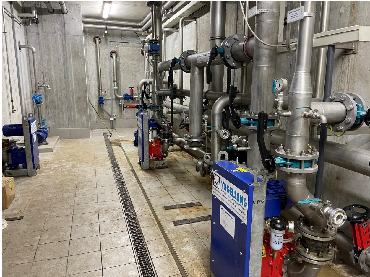
Slika 24. Strojarnica jedinice za biološko pročišćavanje otpadne vode (vlastita fotografija)
