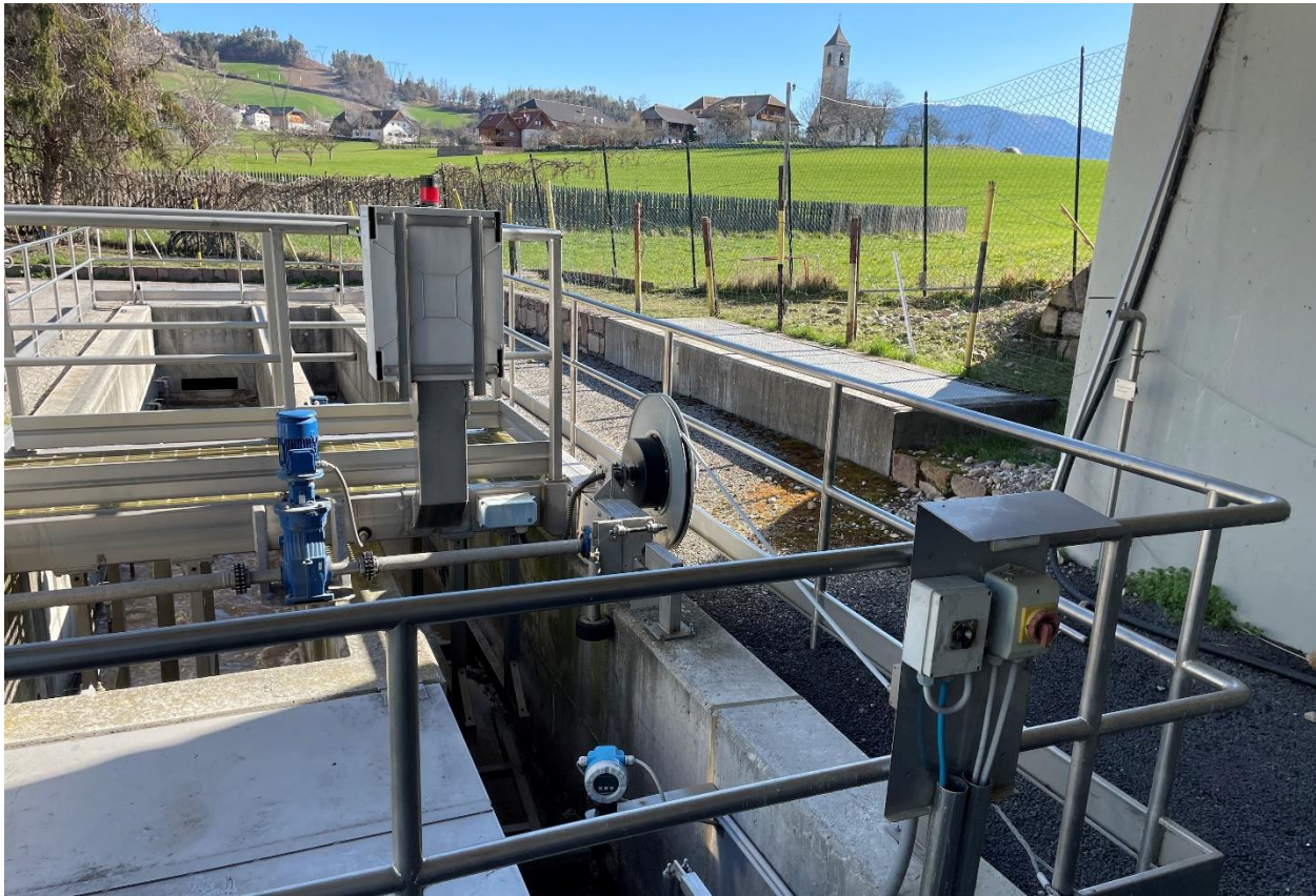
Slika 14. Aerirani pjeskolov i mastolov (vlastita fotografija)
