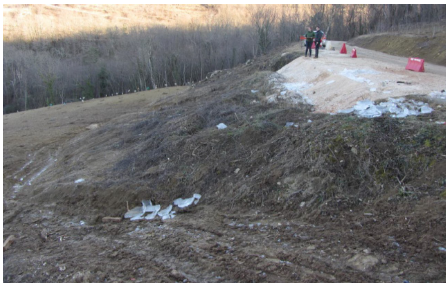
Slika 4. Oštećenje prometnice LC50059 uslijed klizanja [15]
