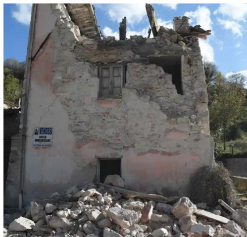
Slika 9. Djelomično prevrtanja zida nakon potresa u Italiji [15]
