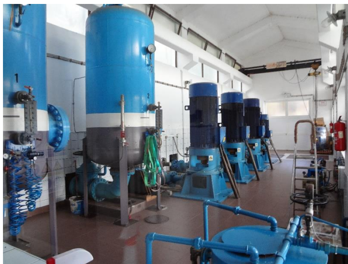
Slika 2.10. Unutrašnjost crpne stanice na Vranskom jezeru na Cresu (izradio autor)
