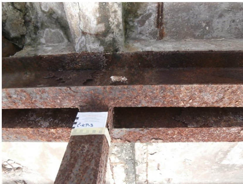
Slika 25 Čelični stup i greda koji se nalaze u prizemlju i na prvom katu konstrukcije te je vidljivo listanje čelika [13]
