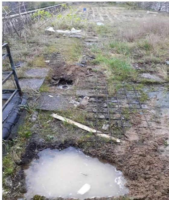
Slika 29 Ploča terase koja je pod stalnih utjecajem atmosferilija i na kojoj se zadržava voda koja utječe na armaturu ploče ali i na sami beton [13]
