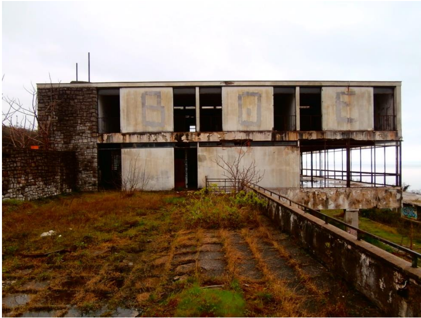
Slika 28 Pogleda na konstrukcije sa vanjske strane gdje je vidljivo korodiranje armature i čeličnih dijelova konstrukcije [13]
