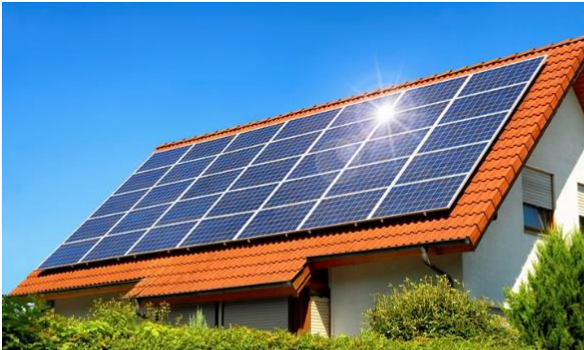
Slika 1: Solarni paneli na krovu [1]
