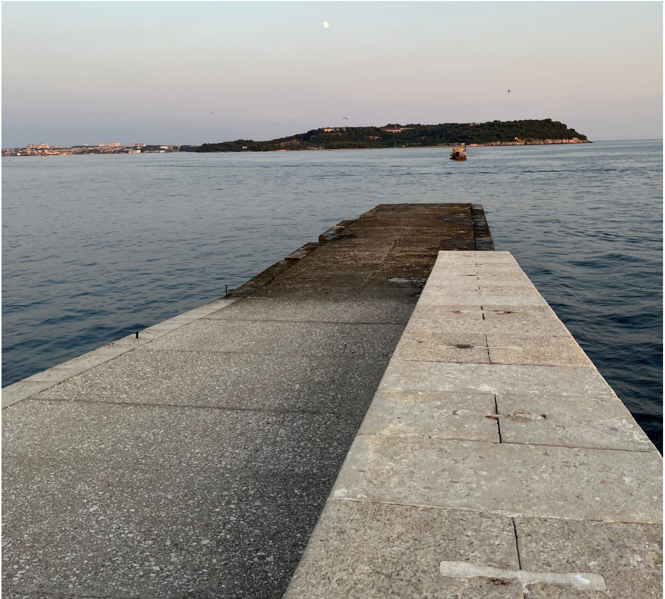
Slika 22: Postojeće stanje glave lukobrana na stacionaži 1+162.15 m za koju se vrši proračun
