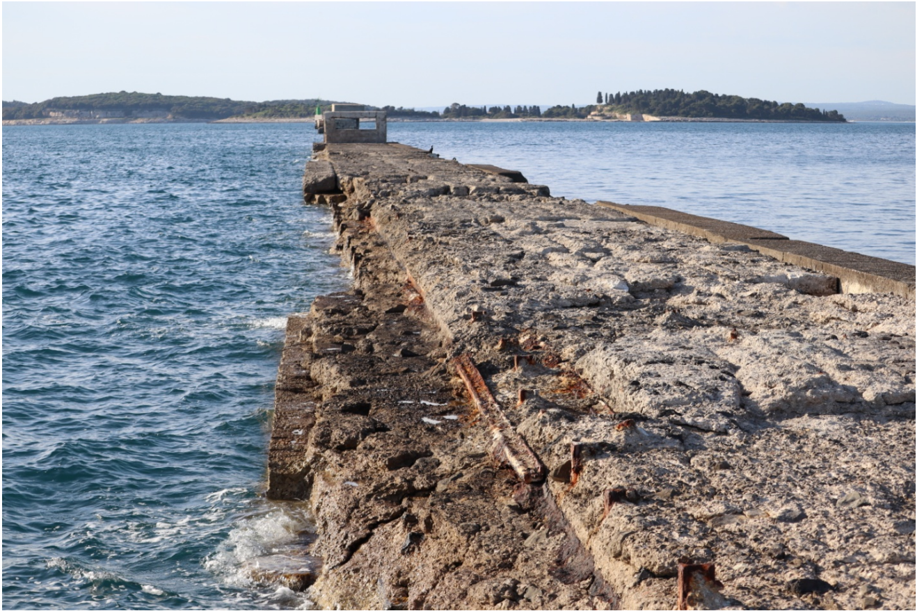
Slika 17: Detalj korodiranih čeličnih profila
