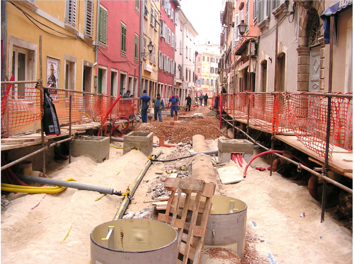
Slika 47: Smještaj okna u gradskoj jezgri, Rovinj – ulica Carera (autor, 2008)
