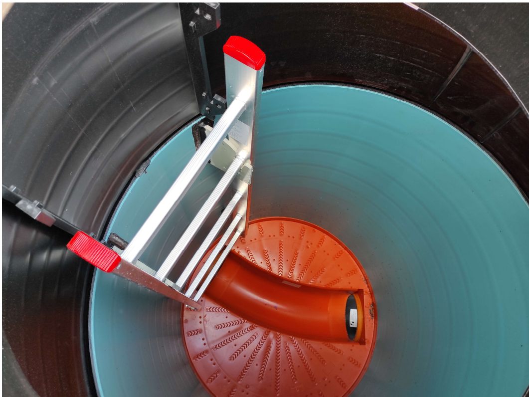
Slika 7: Primjer ljestvi ugrađenih u PP oknu (autor, 2022)
