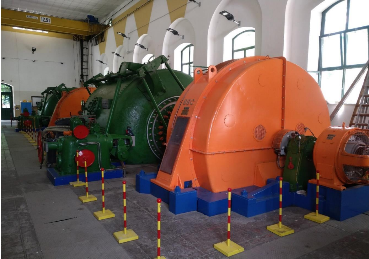
Slika 35: Unutrašnjost strojarnice HE Jaruga [8]
