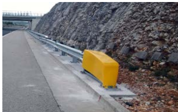
Slika 90. Počeci/završeci zaštitne odbojne ograde
