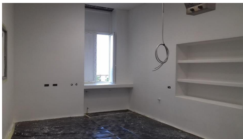
Slika 41: Dovršeni svi slojevi zidova, no još je potrebno ugraditi elemente u zidove te očistiti prostor [Izvor: autor]
