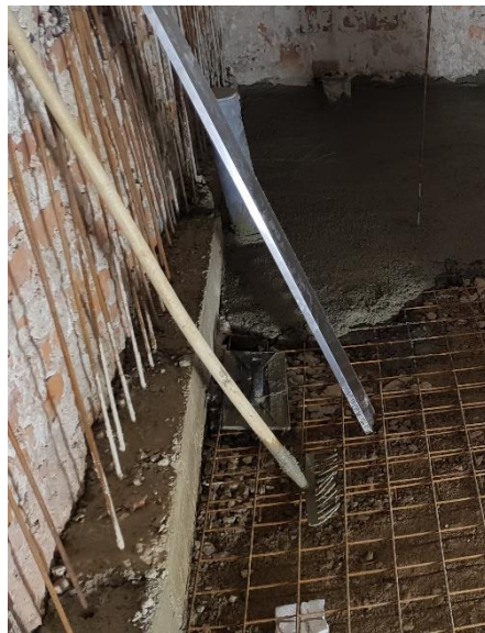
Slika 11: Novo izvedeni temelj postojećeg zida s dodatnom armaturom za povezivanje temelja s budućom betonskom oblogom. [Izvor: autor ]
