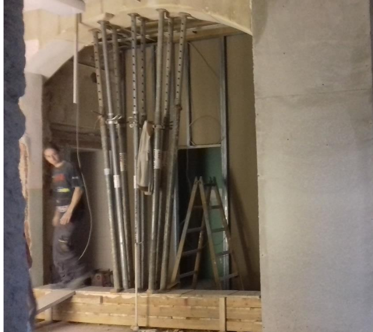
Slika 28: Drvena greda s podupiračima za ojačanje te prijenos opterećenja s postojeće erte. Izvedeno betonsko ojačanje postojećeg stupa ( na slici desno od privremenog ojačanja ) [ Izvor: autor ]
