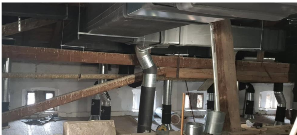
Slika 44: prodori ventilacija prema operacijskim salama na katu niže [Izvor: autor]
