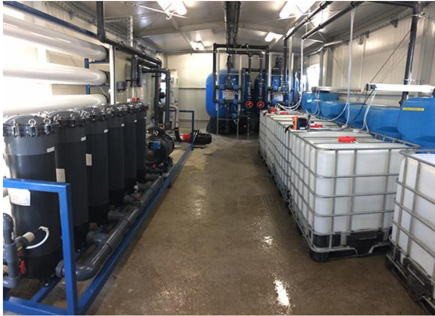
Slika 19. Uređaj za desalinizaciju vode (URL2)
