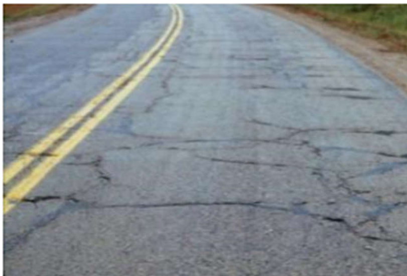
Slika 7: Mrežaste pukotine kolnika [7]
