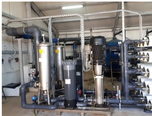
Slika 21: Postrojenje za desalinizaciju bočate vode [25]
