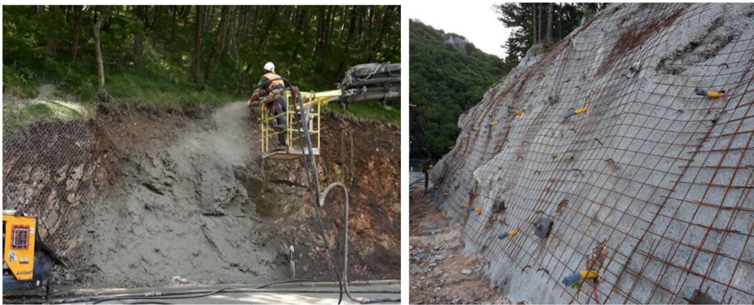
Slika 33: Stabilizacija mlaznim betonom (lijevo), mlazni beton u kombinaciji sa sidrima, armaturnom mrežom i procjednicama (desno) [24]
