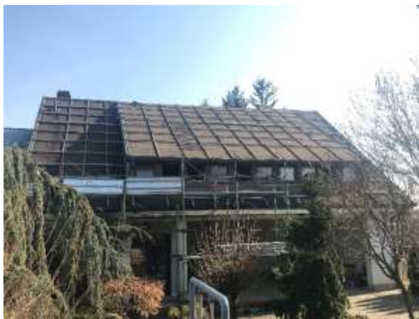
Slika 1: Pokrov bitumenskom ljepenkom na daščanoj oplati – prikaz zapadne strane krova i pročelja zgrade
