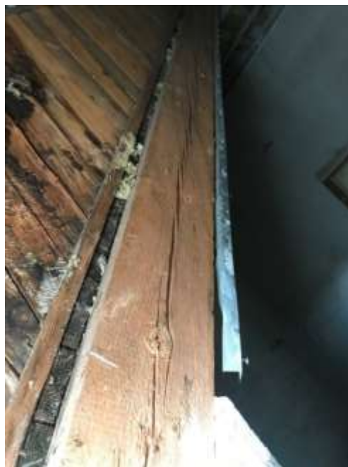
Slika 4.b: Površinske pukotine od skupljanja
