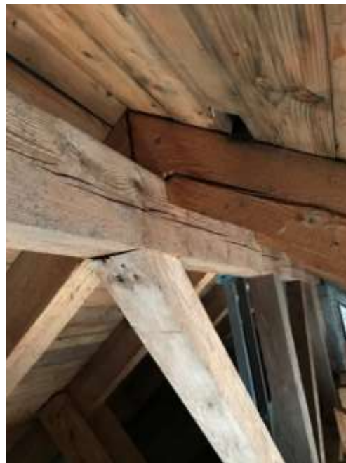
Slika 6: Konstrukcijsko oštećenje zbog stepenastog zasijecanja kombinirano s utjecajem vlage (spoj na sljemenu)
